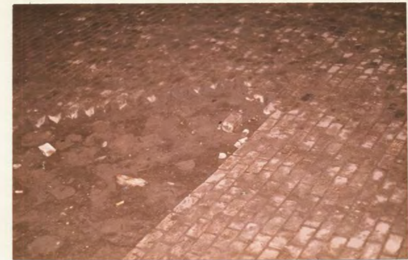
Herausgebrochene Pflastersteine aus dem Gehweg vor dem Hauptbahnhof Dresden und nach den Aufräumarbeiten
